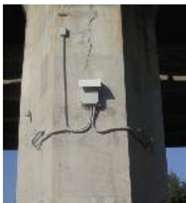
Fig. 2. Manufatto in conglomerato cementizio: monitoraggio microclimatico e strutturale con Grillo MMTS connesso a OLINDA
